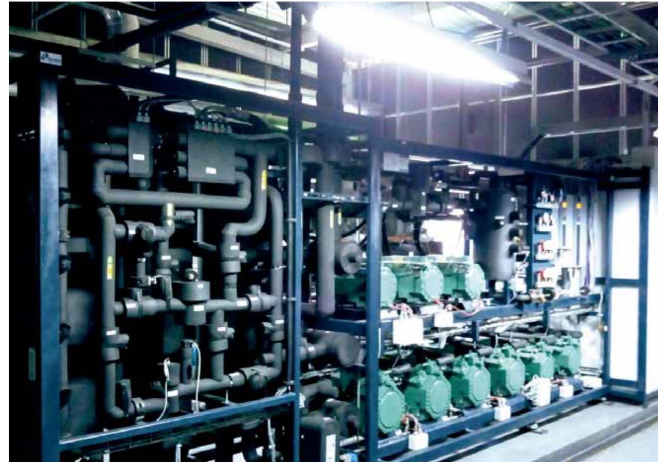
Centrales de Refrigeración
